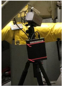
NPP in-situ CZT system
